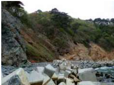
写真-6 地震後の状況 (H23.5.10)
