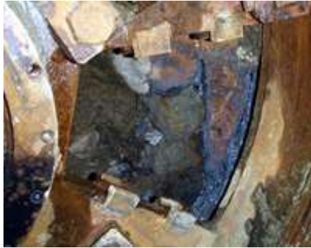
「点検扉」で確認されたH型鋼
