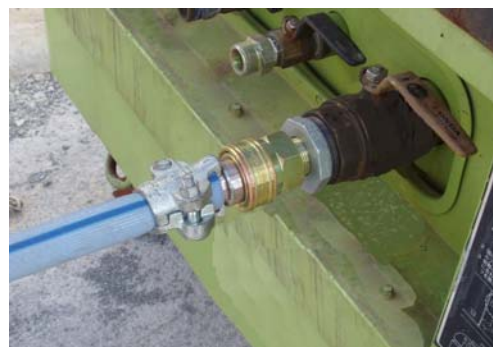
写真一解 4.7.3 空気圧縮機との接続例
