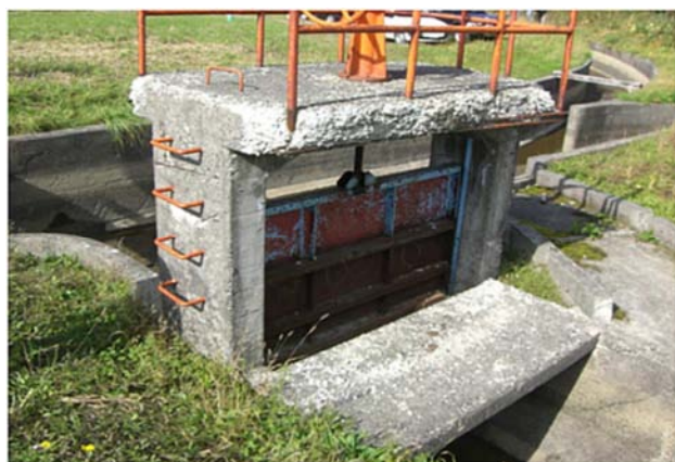
写真7 コンクリートの凍害状況
