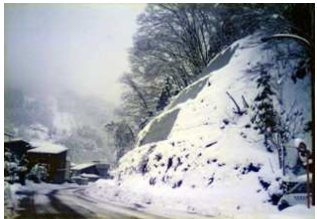
写真4 モルタルのり面の落雪対策 (グレーの部分が塗装面 周りのモルタル吹付面の雪は落ちていない。)
